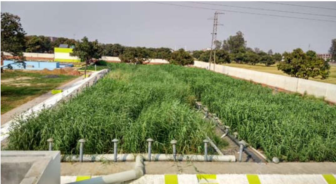
Kombination af 2 beplantede filteranlæg og 2 rodzoneanlæg på i alt 2000 m 2 til 1000 personer til en universitet i Indien. Alt det rensede spildevand genbruges til landbrug og toiletskyl.
